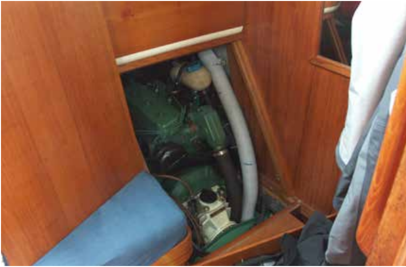
Die Maschine steht in der Achterkammer und ist gut geräuschisoliert. Für größere Wartungs- und Reparaturarbeiten lässt sich die Verkleidung ganz entfernen.
